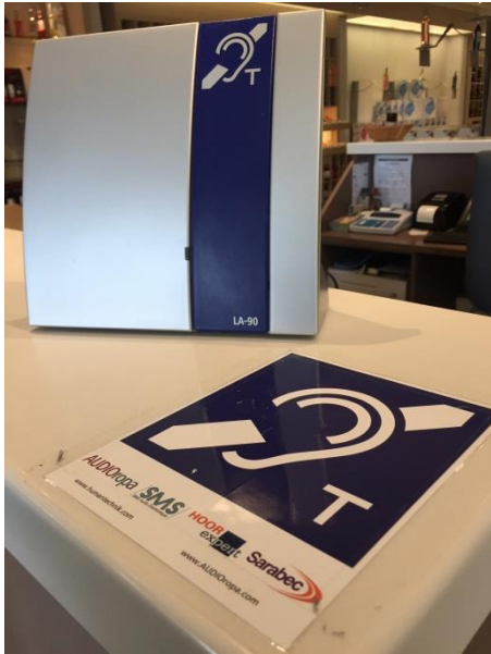
Exemple d'aménagement : boucle magnétique auditive.
